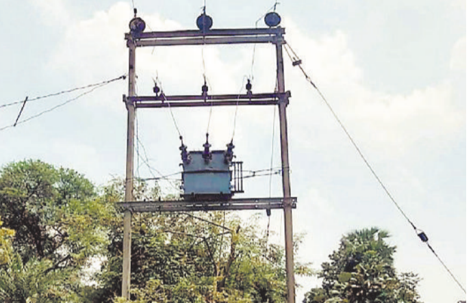
खराब पड़ा ट्रांसफार्मर।
